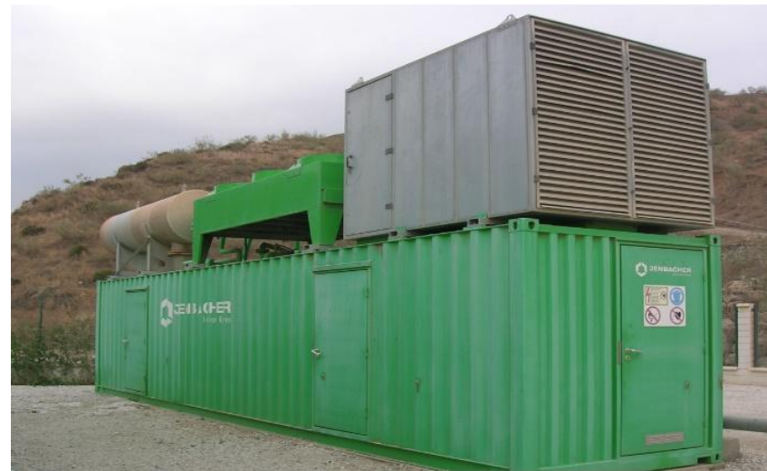
Planta de Desgasificación y producción eléctrica
